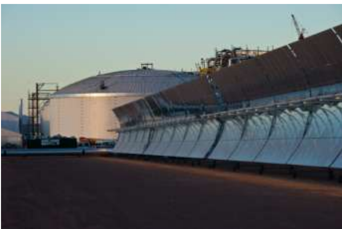
Tanque de almacenamiento de energía térmica
